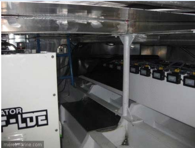
Batteries de l'Ecocono (© : ODC MARINE)
